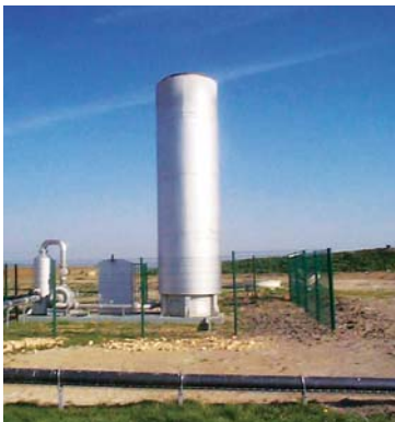
Unité de combustion et de destruction du biogaz : la torchère
